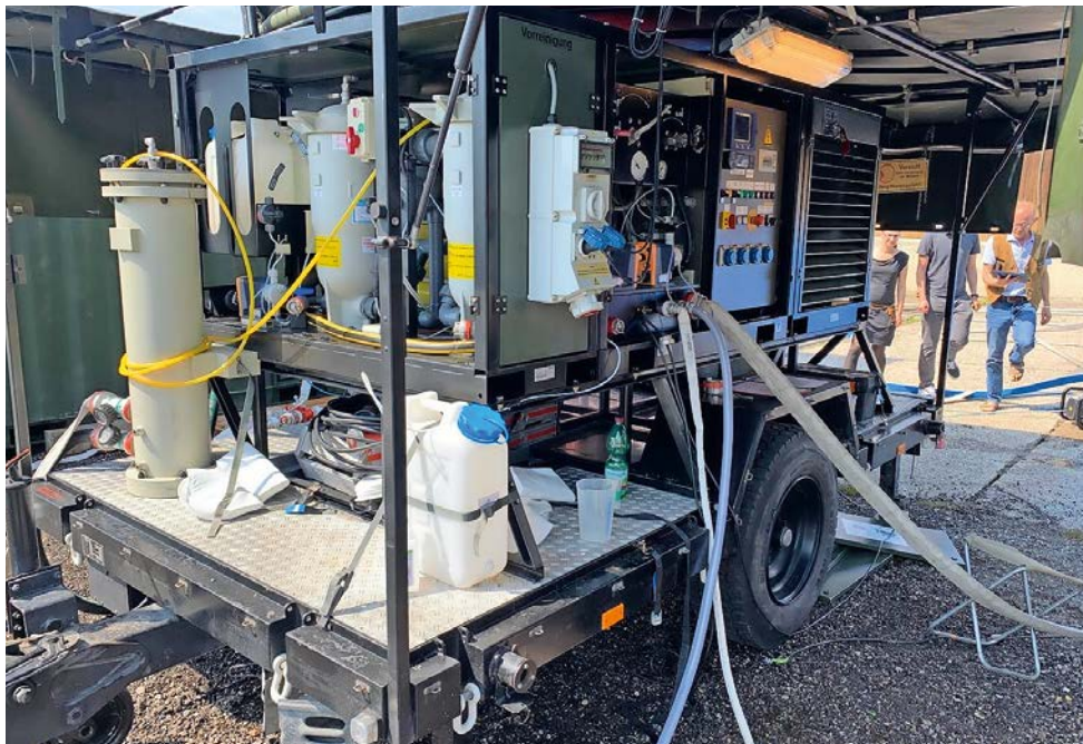
Abb. 1: Mobile Wasseraufbereitungsanlage des Österreichischen Bundesheeres
