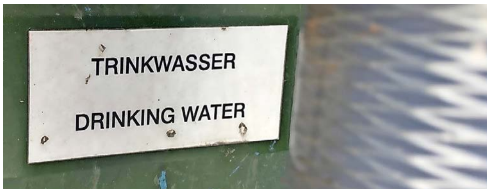
Abb. 2: Detailaufnahme Wasseraufbereitungsanlage des Österreichischen Bundesheeres
